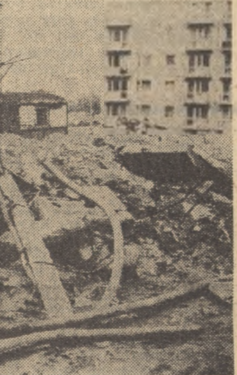
Osiedle „Borki”, ul. Batalionów Chłopskich. Taki nieporządek pozostawili po sobie budowlani
