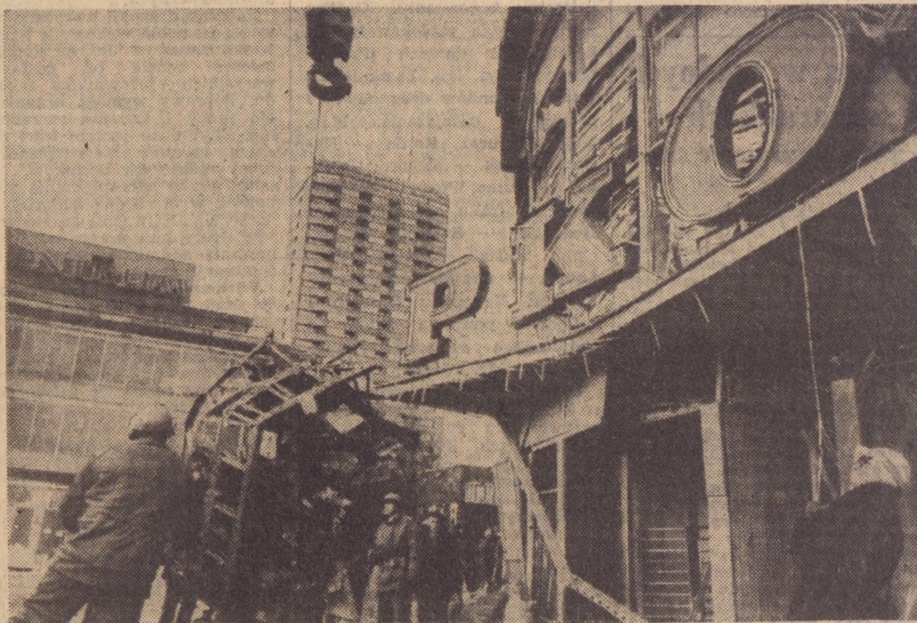
(P) Z wnętrza Rotundy mostostalowcy i strażacy wydobywają tony gruzu i zniszczone elementy wyposażenia — pogiętą regałę, na których gromadzono dokumenty w archiwum.
