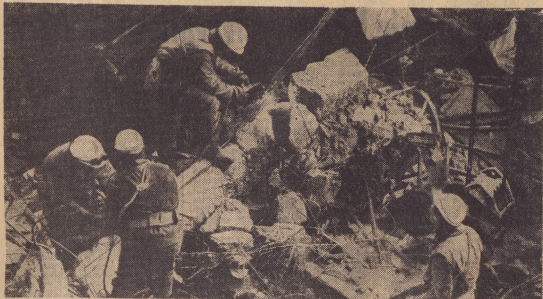
(P) W zawałonej części budynku trwa akcja porządkowa.
