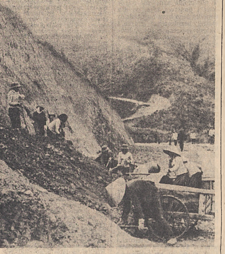
(P) W Laosie wszystko trzeba zaczynać od podstaw. Na zdjęciu: budowa drogi w prowincji Hoa Phan.
