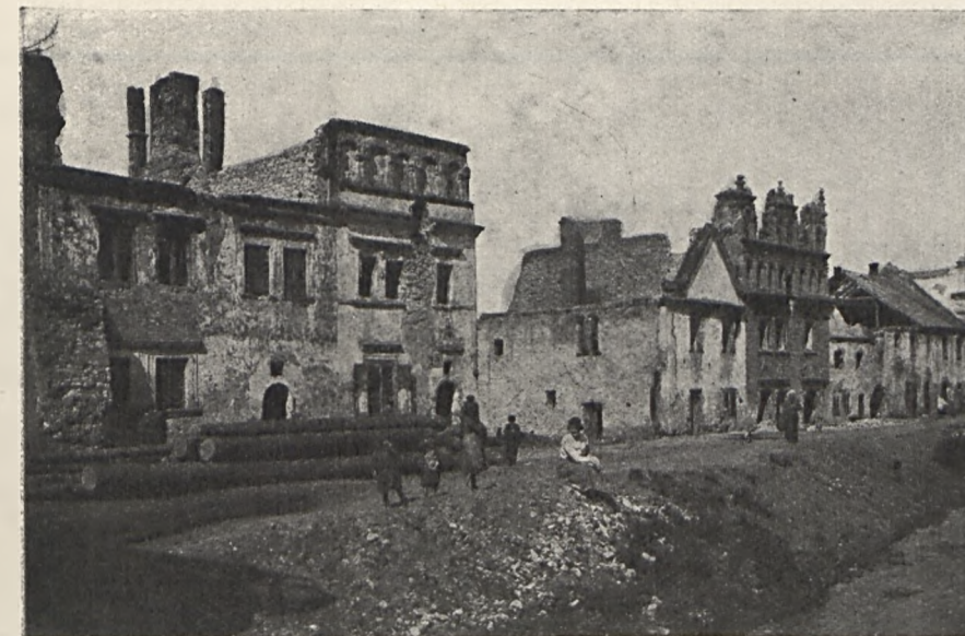
ZNISZCZONE BUDYNKI RENESANSOWE W KAZIMIERZU NAD WISŁĄ ÉDIFICES RENAISSANCE FORTEMENT DÉTÉRIORÉS À KAZIMIERZ SUR LA VISTULE
