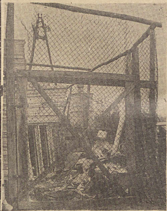
Stare zaplecze „Hydrocentrum” nie zdobi placu budowy
