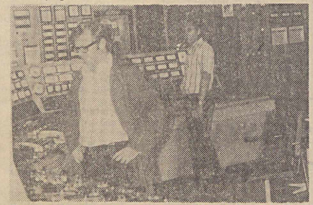
Urządzenia pracują sprawnie, ale w każdej chwili trzeba być gotowym do interwencji.
